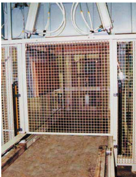
Bild 8: Transport- und Beschickungssystem Fig. 8: Conveying and charging system
